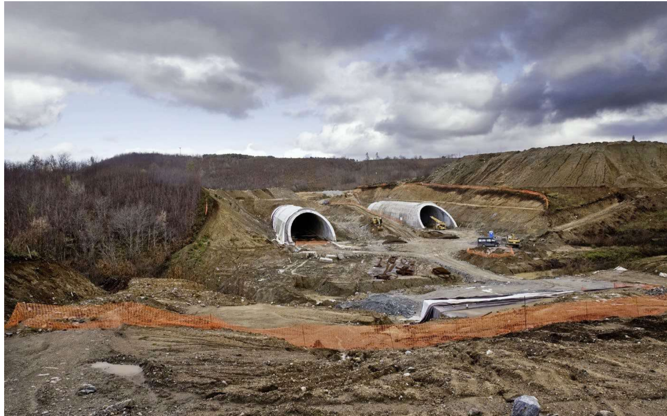
190 Tunnel: Eine Baustelle zwischen Palmi und Scilla in einer Aufnahme von 2008. Foto: Roberto Caccuri (Dukas, Contrast)
